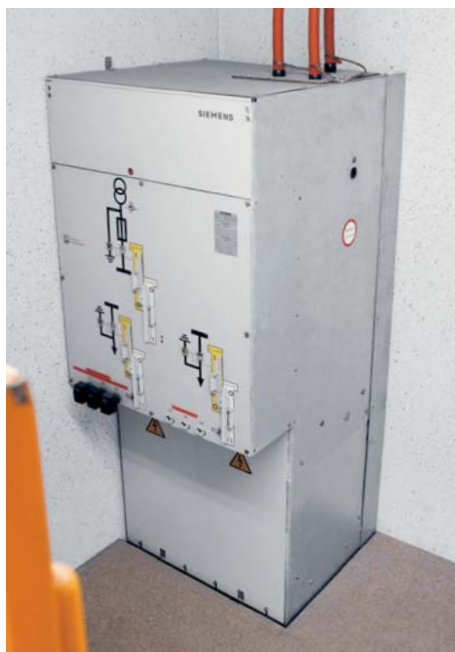
Первое распределительное устройство 8DJ10 с элегазовой изоляцией для вторичных распределительных уровней – коммунальное предприятие "Stadtwerke Lambrecht (Pfalz) GmbH", Германия
