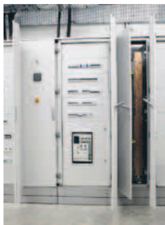
Полностью укомплектованный шкаф XL 3 4000
