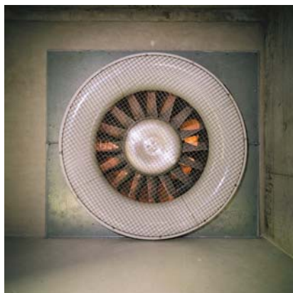
Применение в вентиляционных установках
