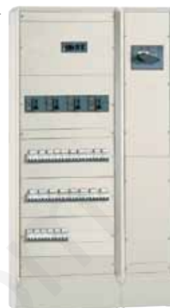
Промежуточный распределительный ЩИТ
